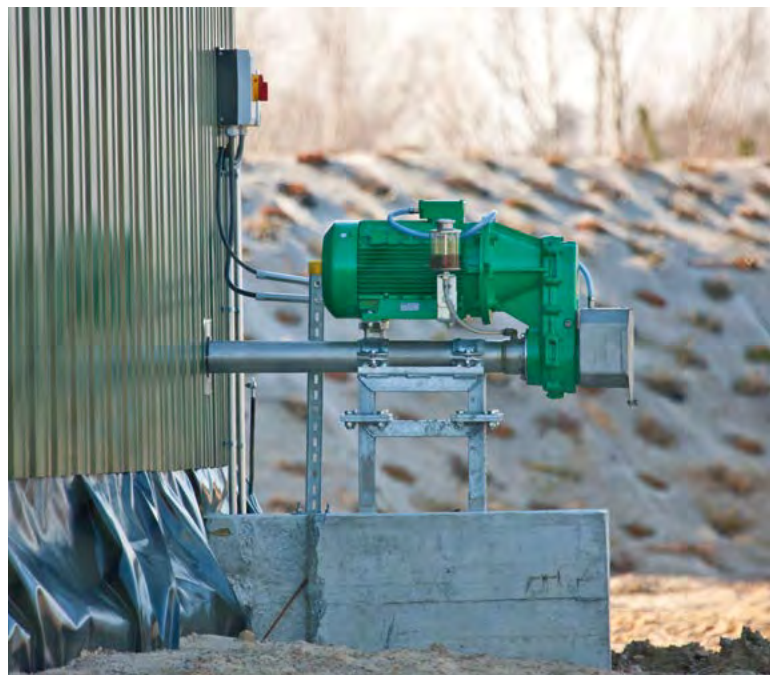
FR stationär - Geschlossener Behälter
