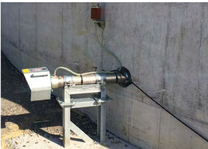
Z3 HY stationär - Betonbehälter
