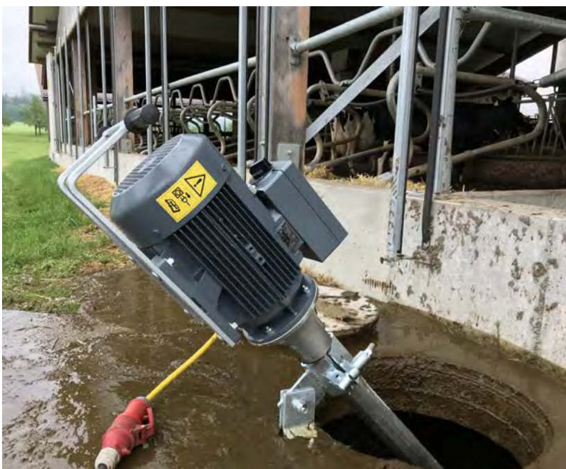
REKORDMIX - Geschlossener Behälter mit Betondecke
